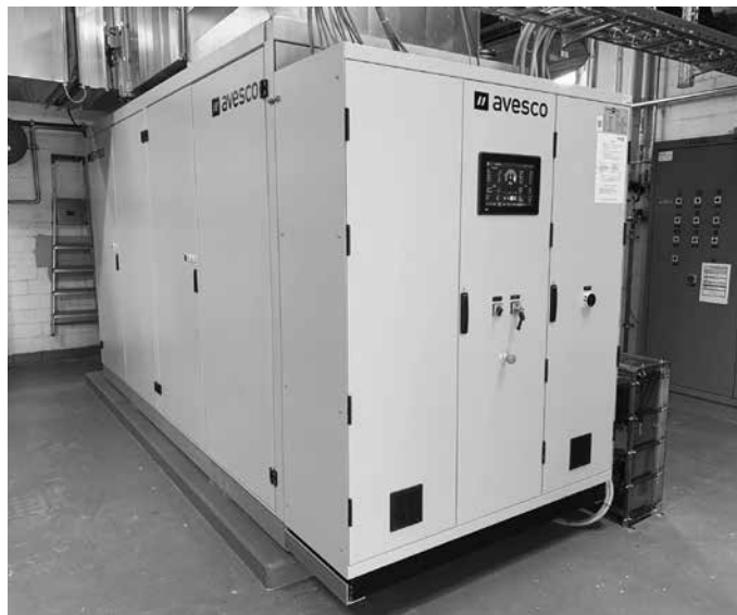
Neues Blockheizkraftwerk (BHKW) in der ARA Rheinfelden-Magden
