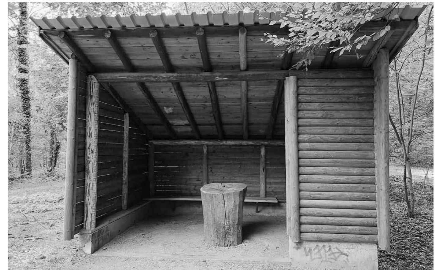
Der Unterstand am Schwarzen Weg wurde durch Feuerlegung beschädigt und musste aufwändig wieder instand gesetzt werden.
