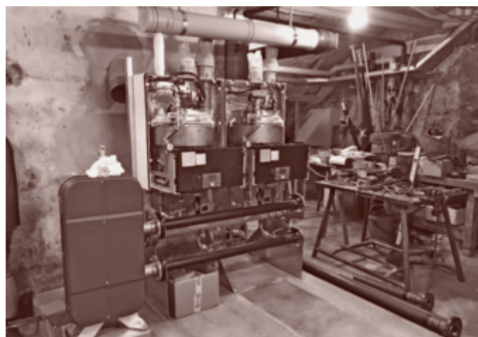
Neue Heizung im Rathaus mit Kaskadenlösung
